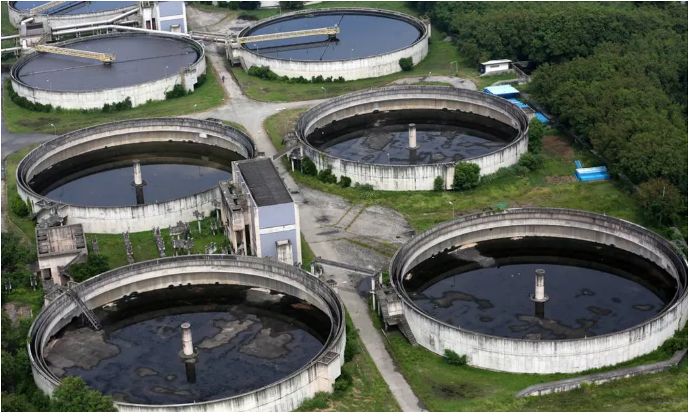
Estação de tratamento de esgoto da Cedae: Nova concessionária atenderá 2,7 milhões de habitantes — Foto: Custódio Coimbra/Agência O Globo
